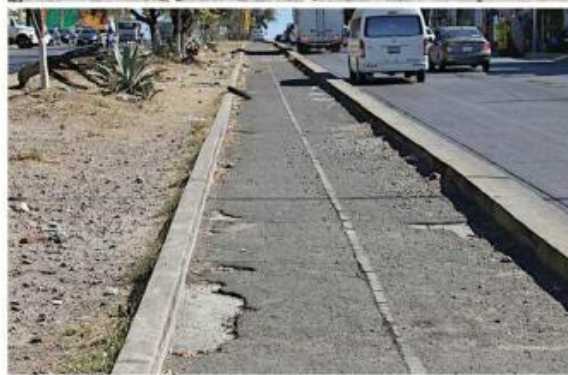
La infraestructura se encuentra dañada en algunos puntos.
