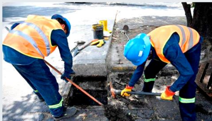
Aún faltan algunos trabajos en vasos reguladores, canales y bocas de tormenta.
