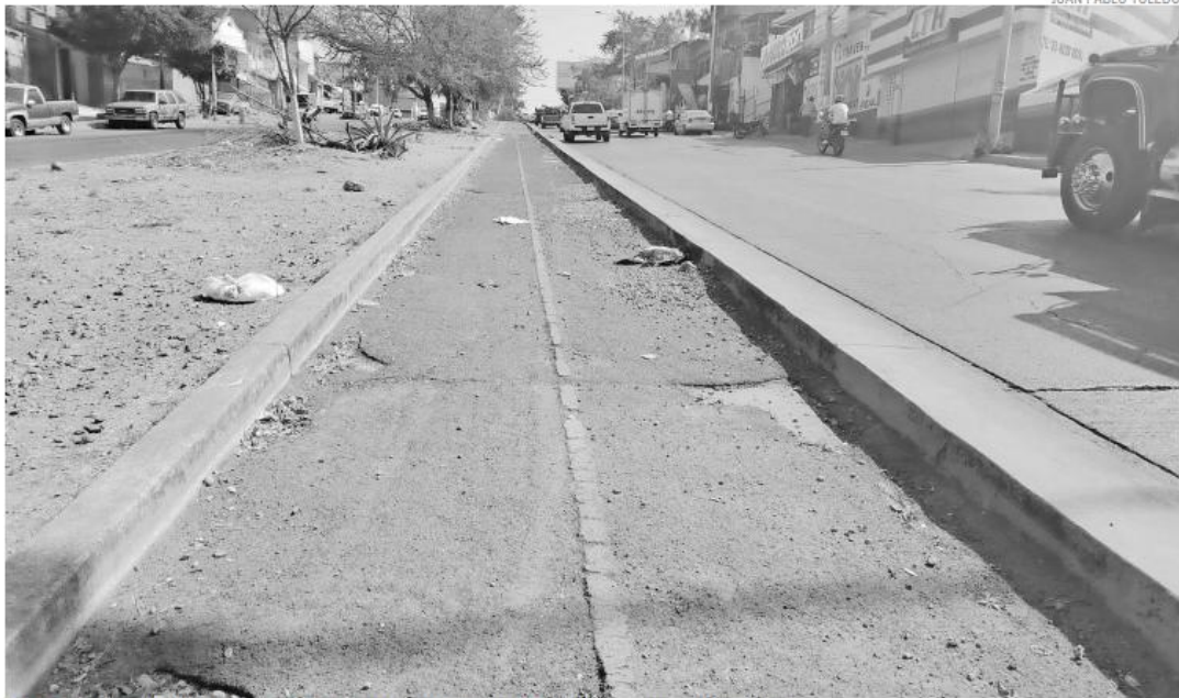
A 18 años de construida la primer ciclovía en la ZMG presenta deterioro y poca conectividad.
