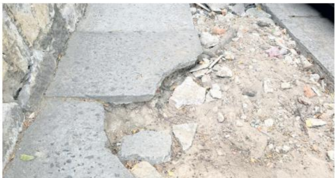
PROVIDENCIA. Las banquetas en algunas partes se encuentran dañadas.
