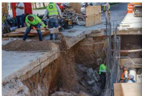
■ El socavón se generó muy cerca de la infraestructura de la Línea 3 del Tren Ligero.
