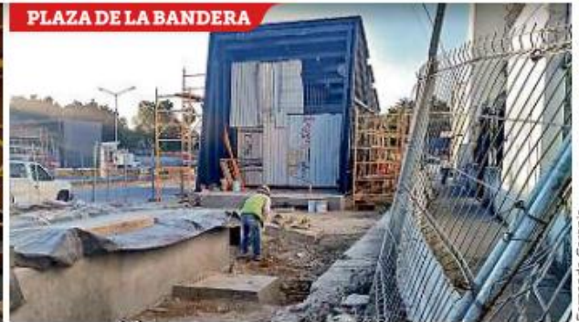
■ Los ingresos a la parada subterránea siguen en construcción y la obra aledaña tampoco ha concluido.
