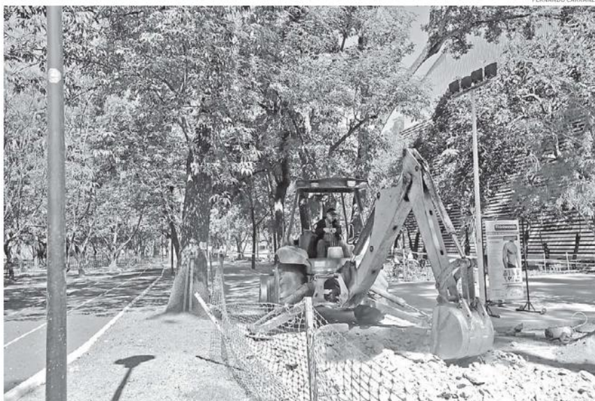
Vecinos del parque San Rafael reclaman la destrucción de árboles y daños en una zona de manantiales
