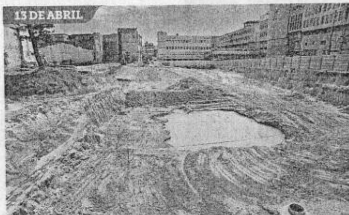
INNOVACIÓN ACUÁTICA. El miércoles 13 de abril se apreció emanación y acumulación de agua tras los trabajos de excavación en donde se construirá el primer complejo de CCD.
