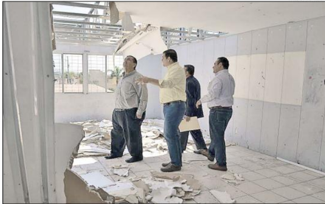
EL SECRETARIO de Educación, Francisco Ayón; el alcalde de Tlajomulco de Zúñiga, Alberto Uribe; y autoridades del Instituto de la Infraestructura Física Educativa, caminaron entre los escombros y corroboraron los daños en la Secundaria Técnica 172.
