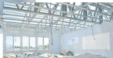
➤ IMPOSIBLE arriesgar al alumnado en aulas tan dañadas debido a la mala calidad de los materiales.
