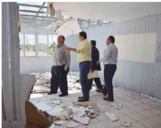
COLAPSA TECHO. Autoridades observan los daños en la Técnica 172.
