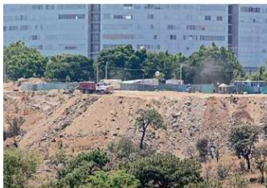
■ En terreno ubicado en Paseo Valle Real 913, camiones de volteo arrojan escombros para nivelar el lugar. No tienen licencia.
