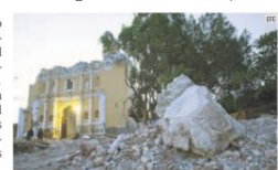
PUEBLA. Estado en que quedó la iglesia de Santiago Apóstol en la población de Atzala.
