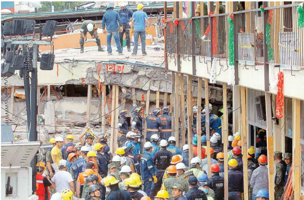
Al cierre de la edición, cuerpos de rescate habían apuntalado una losa para facilitar la remoción de escombros en el colegio Enrique Rébsamen de la CDMX, con la esperanza de poner a salvo a una alumna.
