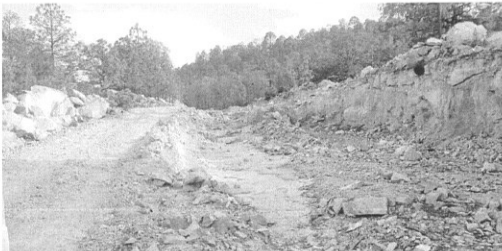
Los daños fueron ocasionados por la administración de Emilio González con la carretera ilegal en Santa Catarina Cuexcomatlán
