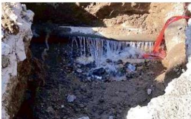
■ Las fugas en tuberías merman el abasto en las metrópolis.
