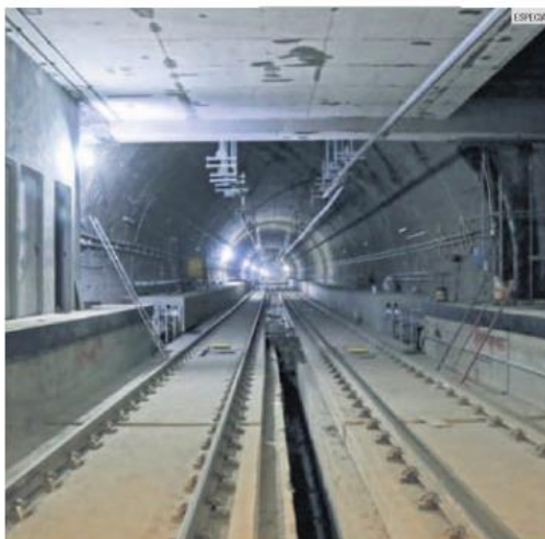
TRABAJOS. La autoridad afirma que están controladas las filtraciones en el túnel.
