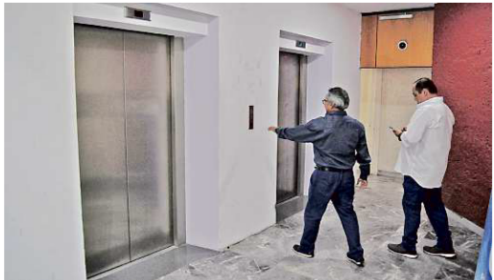
Los elevadores en el edificio del Congreso, ubicado en Juárez 237, no sirven.
