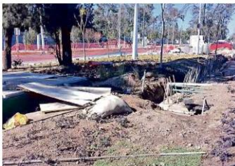
■ El Viaducto Belenes se entregó el pasado 5 de diciembre al 95 por ciento; aún hay escombros en la parte superficial.
