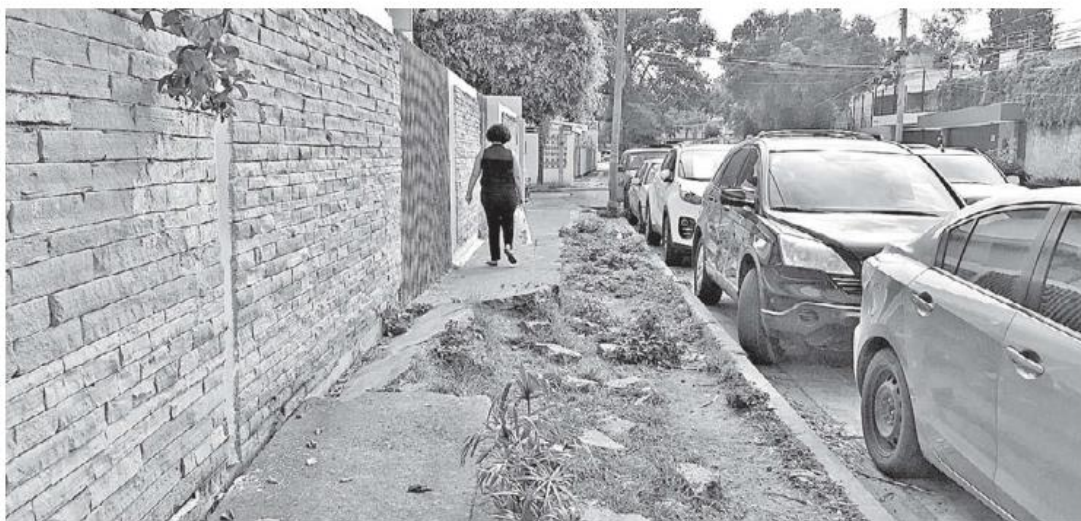
El estado de las banquetas ponen en riesgo a los transeúntes. ESPECIAL
