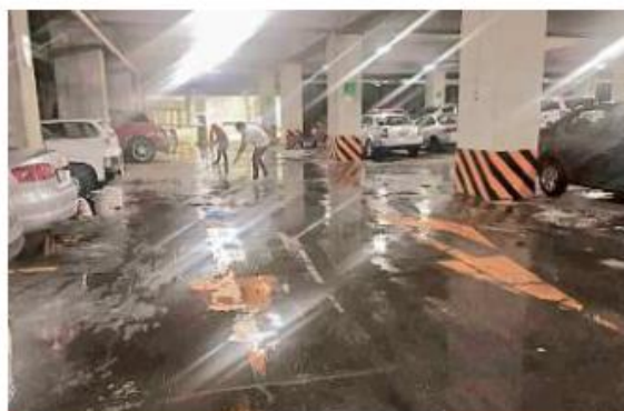
■ De acuerdo con la empresa, de los 527 cajones de estacionamiento, 60 son inutilizables por las filtraciones de agua.
