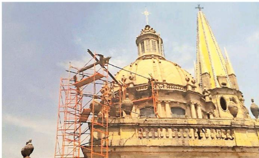
Se registran grietas propiciadas por la Línea 3 del Tren Ligero. CORTESÍA
