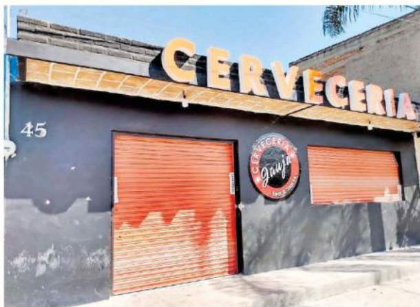
En recorrido de EL OCCIDENTAL se apreció que en la fachada y la cortina del establecimiento tenía 10 impactos de bala. ROMÁN ORTEGA
