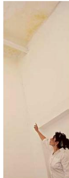
■ Susana muestra las filtraciones que se mantienen en las paredes, cuando antes no había.
