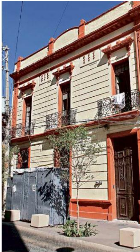
■ La casa en Reforma 316 fue desalojada por 12 meses, debido a las fisuras que registró con la construcción del túnel de la L3.
