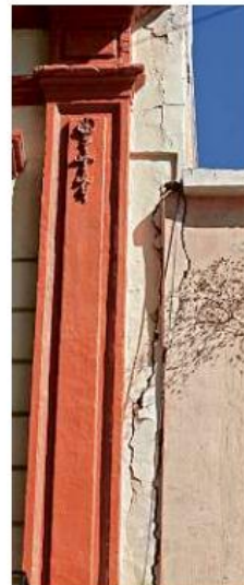
■ En el exterior, la fractura en el inmueble aún es visible.
