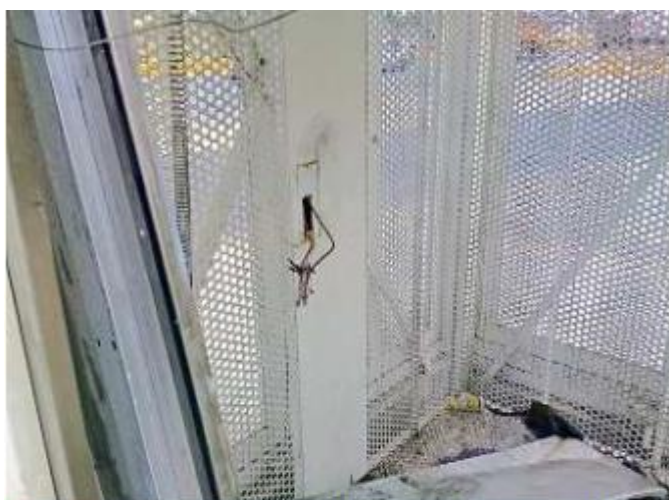
El ascensor ubicado en el lado oriente fue abierto a la fuerza y su interior se utiliza como sanitario.
