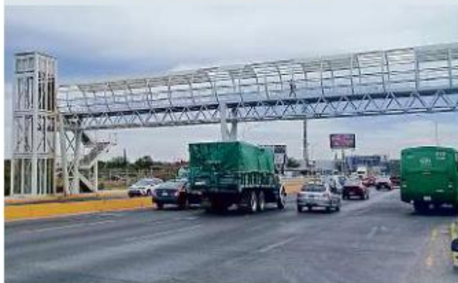
A la parte superior del puente le faltan unas láminas.
