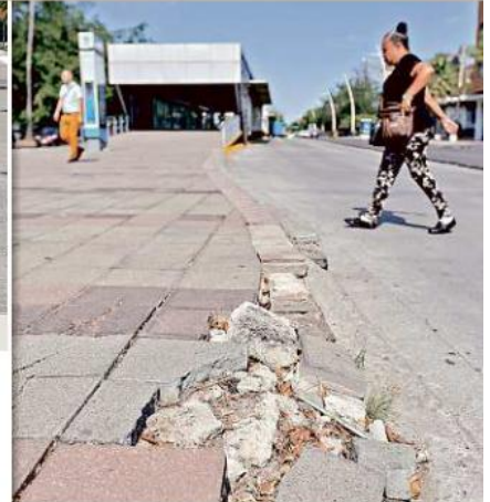
Así luce el exterior de la Estación Alameda del Macrobus, en la esquina de Juan Manuel.
