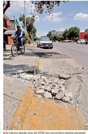
■ Al menos desde julio de 2016 hay escombros obstaculizando el paso en la ciclovia de Calzada Federalismo, casi en la esquina con Plan de San Luis.
