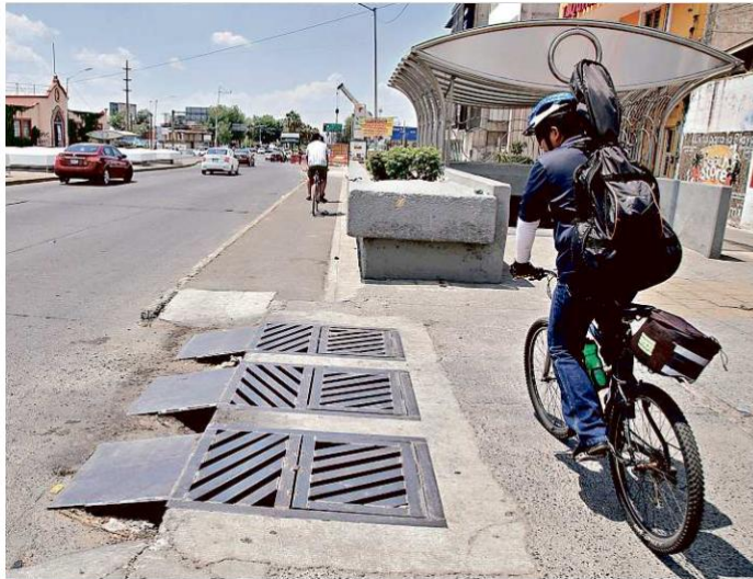
■ Según la vista de calle de Google Maps, desde agosto de 2014 se colocaron estas bocas de tormenta y rampas metálicas sobre la pista para ciclistas de Federalismo, del lado oriente, entre Avenida Ávila Camacho y Mar Rojo.
