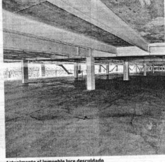
Actualmente el inmueble luce descuidado
