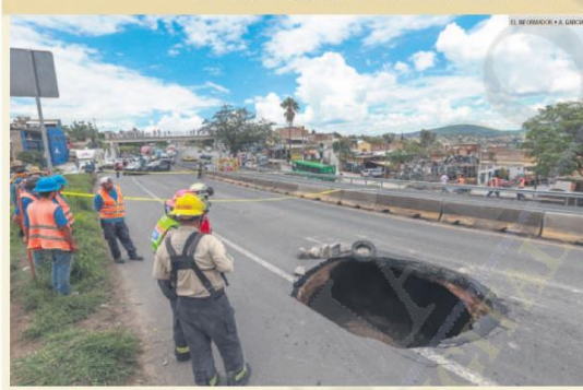
SALDO DE LAS LUVIAS. La Secretaría de Comunicaciones y Transportes (SCT) detectó un socavón profundo sobre la Carretera a Saltillo, a la altura del kilómetro 9, lo que obligó a la dependencia a cerrar la circulación sobre los cuatro carriles de esa vialidad, en el sentido de ingreso a Guadalajara. Se informó que el hoyanero será reparado en un plazo máximo de tres días, en tanto las condiciones climáticas así lo permitan. La delegación Jalisco de la SCT agregó que se trata de un "hundimiento considerable".
