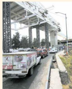
CARRETERA TESISÁN Y PERIFÉRICO. En este punto son constantes los percances.
