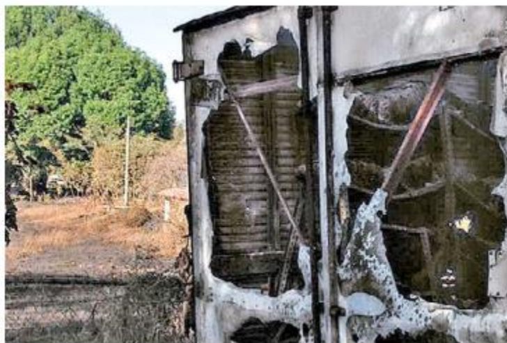
El incendio ocurrió en un depósito en Tlajomulco. MILENIO
