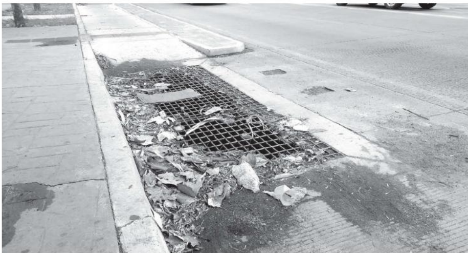
La acumulación de basura y diversos obstáculos arrastrados por la lluvia son otros de los problemas que deben sortear los ciclistas
