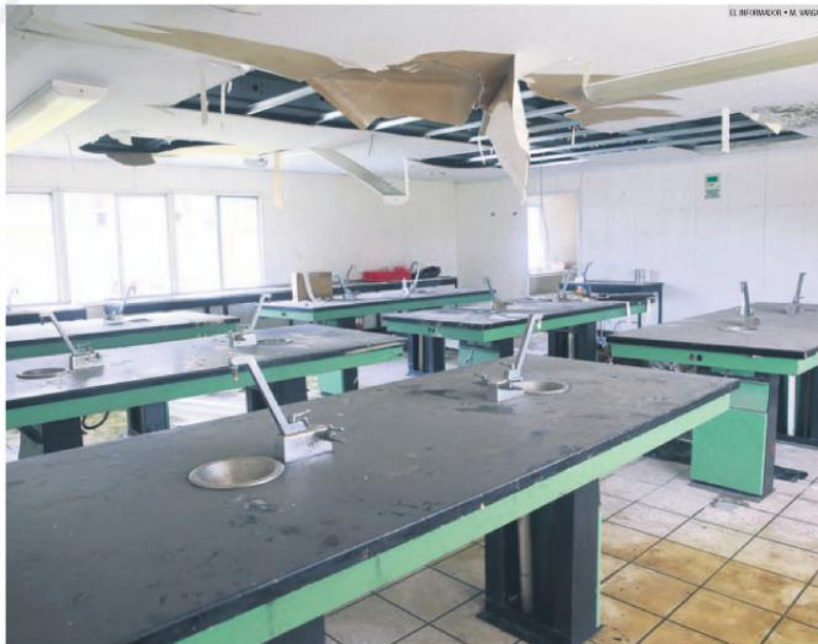
DESTRUIDO. El laboratorio de ciencia de la Secundaria Técnica 172 quedó arruinado el pasado 19 de junio debido a las lluvias.
