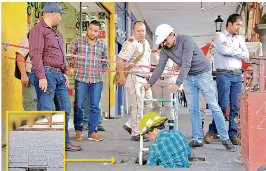
Elementos de Protección Civil inspeccionan el socavón para su valoración; lo que parecía un azulejo suelto resultó ser una oquedad de 2 metros de profundidad y 3 de ancho.
