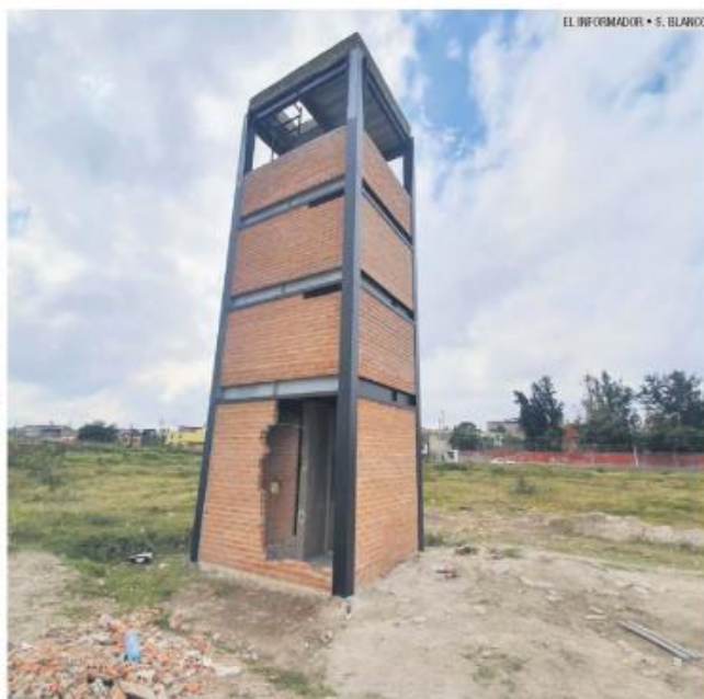
DAÑO. Una de las torres ya presenta dos boquetes: uno grande y otro pequeño.
