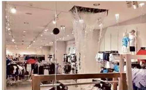
■ En una plaza comercial ubicada sobre Avenida Rafael Sanzio y Vallarta, el agua se coló hasta los locales.
