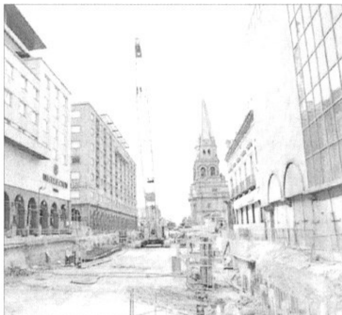
>> LA EMPRESA constructora está más preocupada por resolver las inundaciones que los daños a las fincas de la zona.
