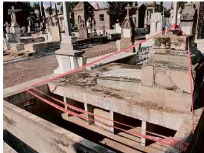
■ Se han colocado cintas para advertir de los riesgos.
