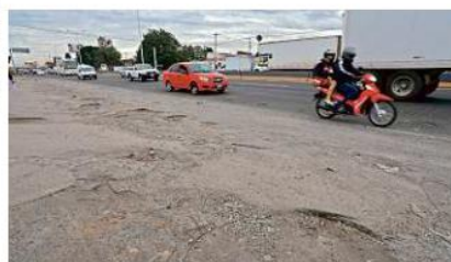
■ Los carriles de acotamiento son un problema para quienes los transitan por su mal estado.
