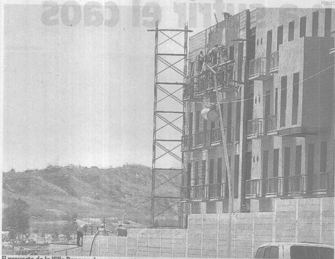
El proyecto de la Villa Panamericana incumple con las normas de densidad y funcionamiento hidrológico
